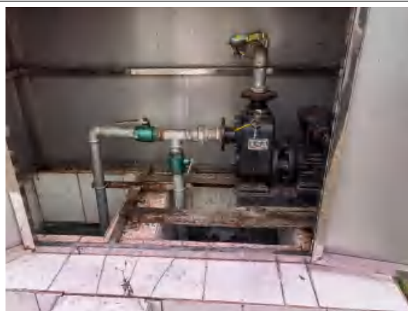
图 14 水位观测井集潜水泵
