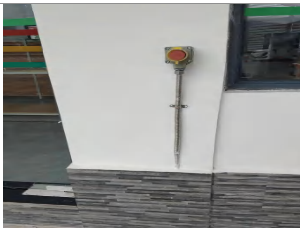
图 22 站房外侧靠近加油区一侧急停开关 1
