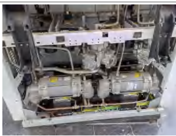
图 8 汽油加油机油气回收泵
