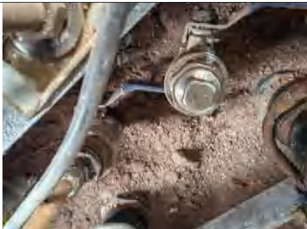
图 25 汽油加油机内部油气回收检测口丝堵
