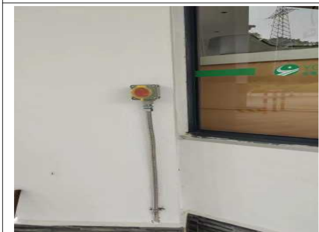
图 23 站房外侧靠近加油区一侧急停开关 2
